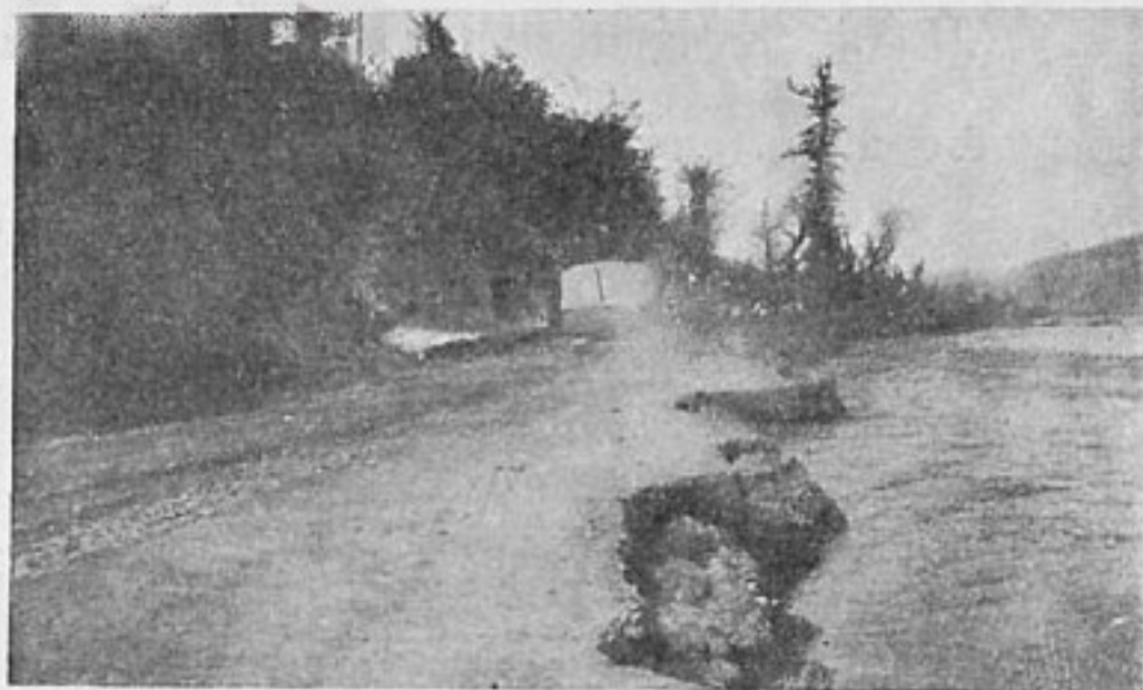
Размыв пути горными водами
